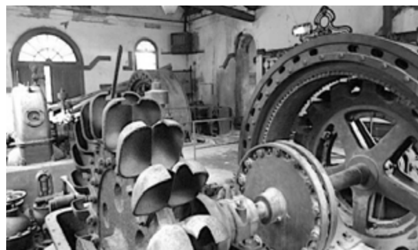
Figura 5. Estado de la antigua central hidroeléctrica de Chivilingo después del terremoto del año 2010. Fuente: Fotografía del autor, julio 2015. Figure 5. Status of the old Chivilingo hydroelectric power station after the 2010 earthquake. Source: Author's photo, July 2015.
